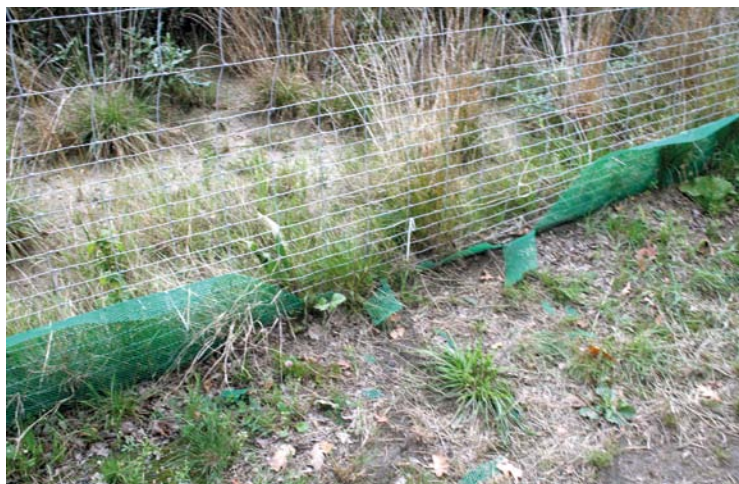
Fot. 42. Często spotykane uszkodzenia siatek polimerowych
