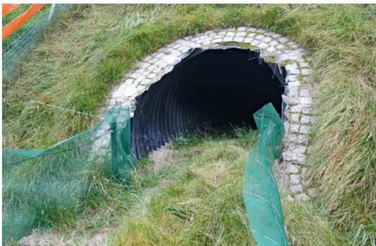
Fot. 48. Niestabilne wykonanie odgięcia górnej krawędzi
