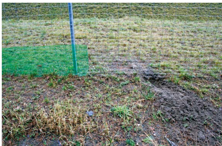
Fot. 35. Podkop pod zbyt krótkim ogrodzeniem
