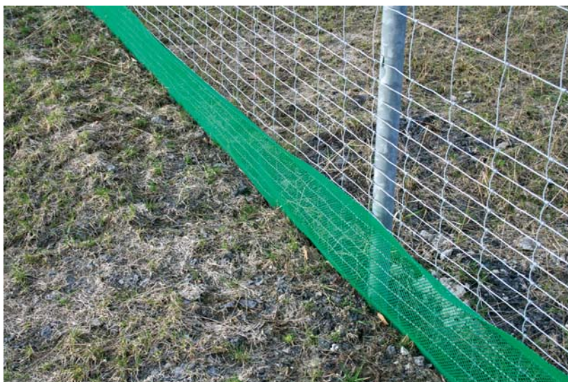
Fot. 20. Ogrodzenie ochronne wykonane z siatki polimerowej
